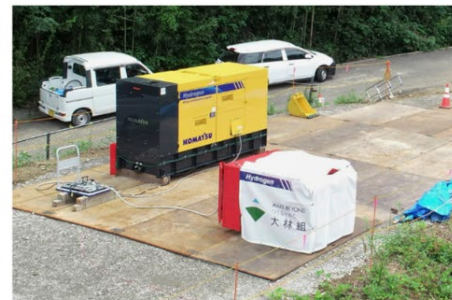
水素混焼発電機（左上）と水素カードル（右下）
