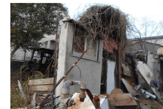
瓦礫の放置(火災跡)
