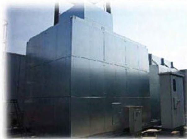
熱源機（高性能サイレンサー）
