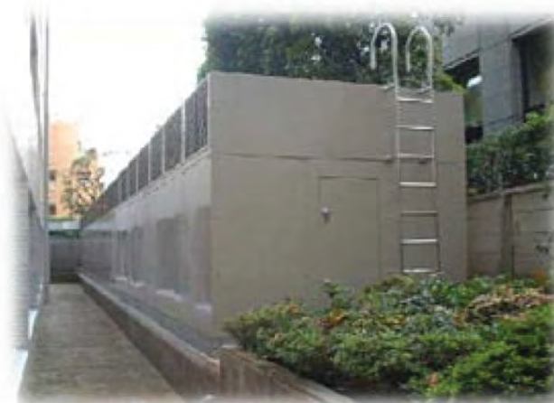
室外機（高性能サイレンサー）
