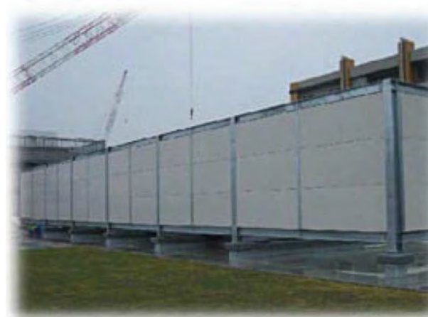
室外機（防音壁）
