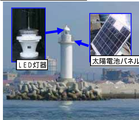
災害時でも自立型電源であるため安定的な電源供給可能
