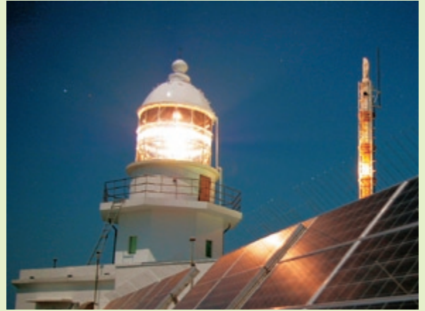
太陽光発電を利用した女島灯台
