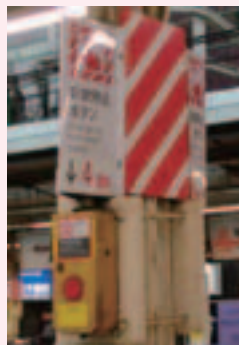
非常停止押しボタン
