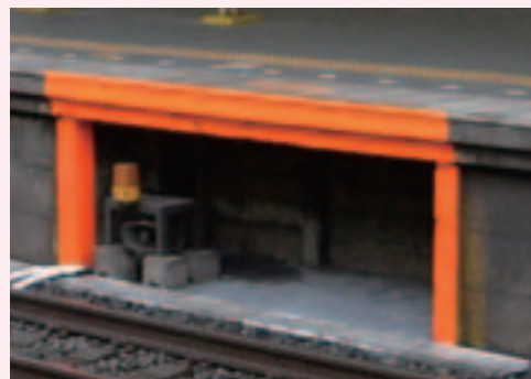
ホーム下の待避スペース
