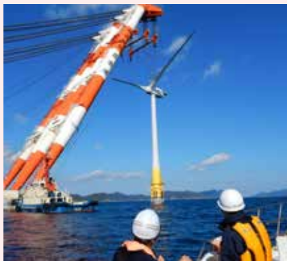
図3. 洋上風力発電設備の様子
