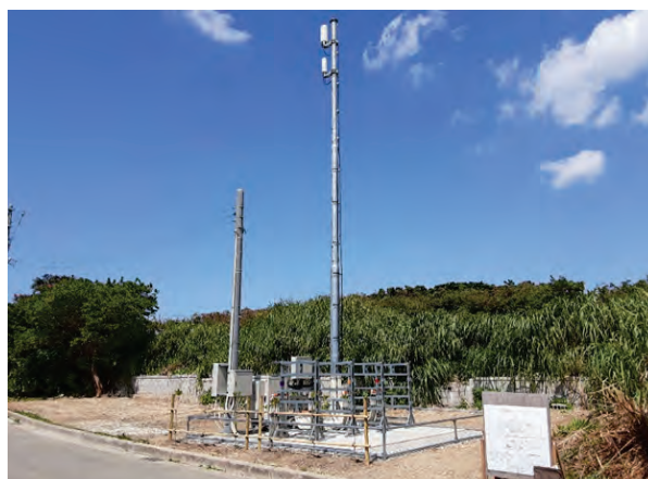
離島に設置された5G基地局 (提供:(株)JTOWER)
