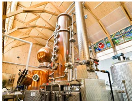
【導入した蒸留装置】
