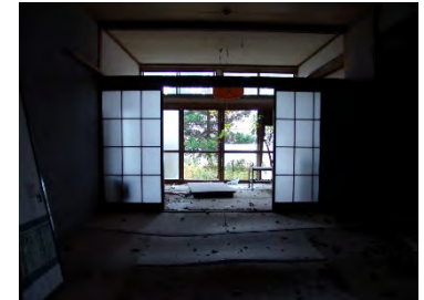
老朽化したホテル・旅館の改修
