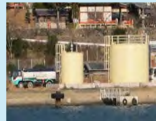
・離島における油槽所
