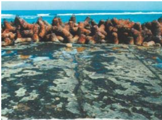
護岸コンクリート部の劣化
