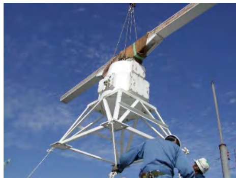
空中線回転機構部の定期交換
