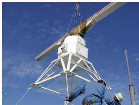
空中線回転機構部の定期交換
