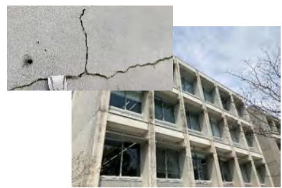
横浜研究所 外壁のひび割れ
