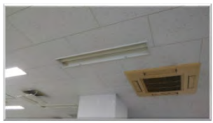
既存 空調室内機と照明器具
