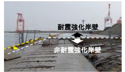
耐震強化岸壁と一般岸壁の被災状況
