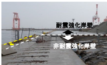
耐震強化岸壁と一般岸壁の被災状況
