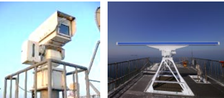
監視カメラの整備
