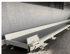
荷物搬送設備
