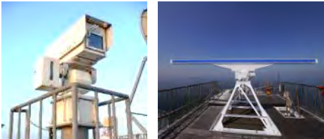
監視カメラの整備
