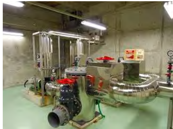
取水ポンプ（取水ポンプ室地下 1F）
