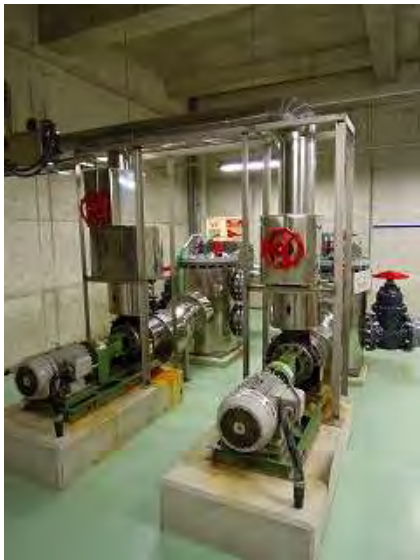
取水ポンプ（取水ポンプ室地下 1F）
