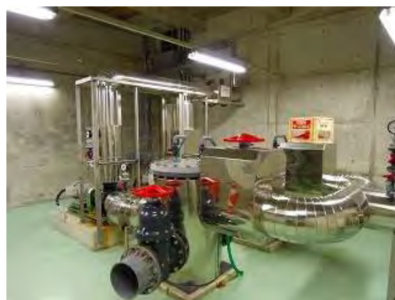
取水ポンプ（取水ポンプ室地下 1F）
