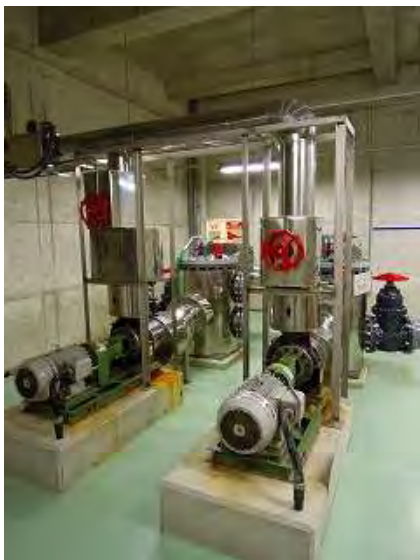
取水ポンプ（取水ポンプ室地下 1F）
