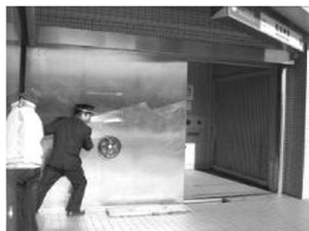
写真 止水鉄扉
