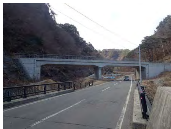
写真 復旧後の旧北リアス線・コイコロベ沢橋梁
