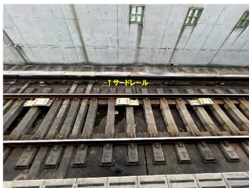
近鉄けいはんな線 軌道・電車線路
