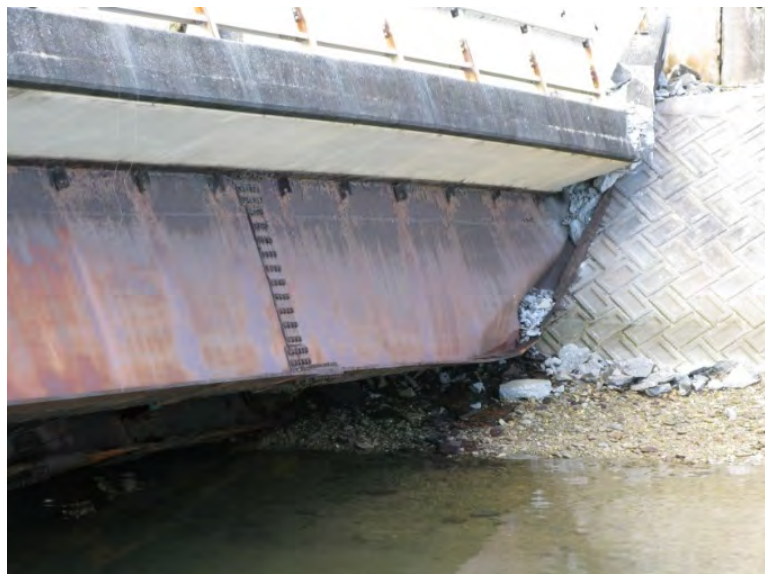
腐食で落橋した鋼桁橋(国頭村)
