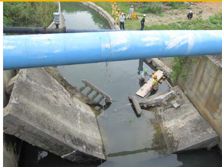
塩害で落橋したRC橋(大宜味村)
