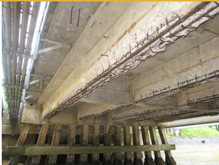
塩害劣化したRC桁橋(金武町)
