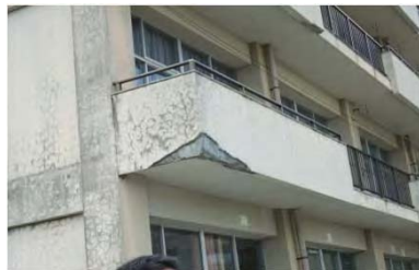
壁が剥がれ落ちた校舎
