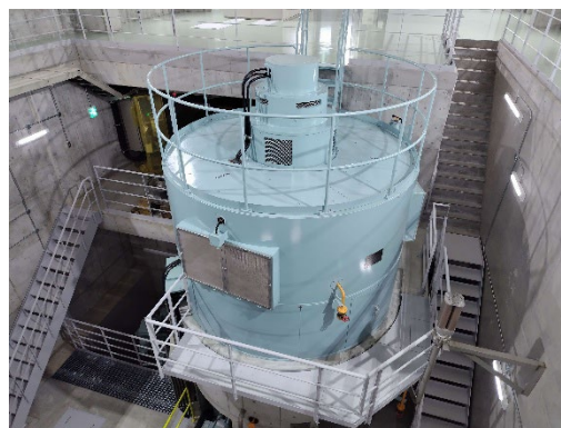
日野川第一発電所（発電機）
