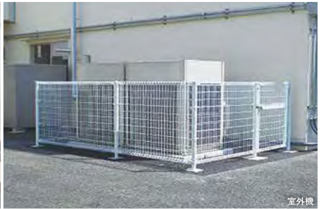
小学校エアコン
