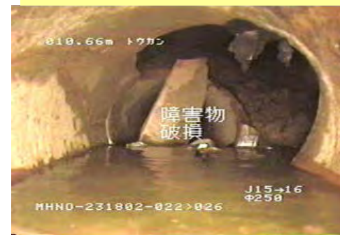
老朽化等による破損、クラック
