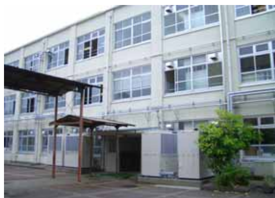
空調設備の室外機（写真中央部）
