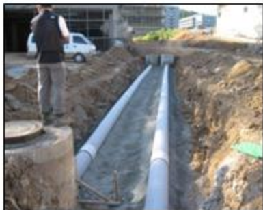
- 실내체육관 측면 우오수배관
