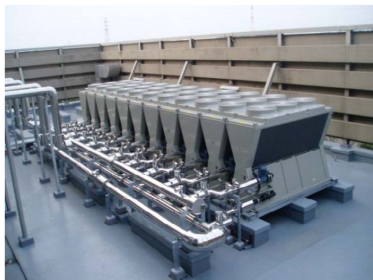
○空調用ヒートポンプチラー(242RT)更新
