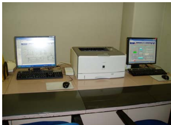
○中央監視設備改修と機能向上による省力化
