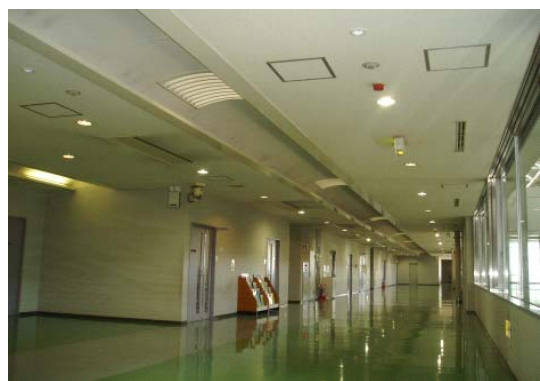
○廊下照明のセンサ化(事務棟3階)
