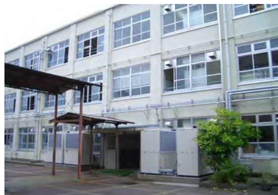
空調設備の室外機（写真中央部）
