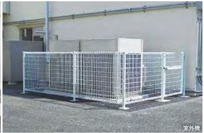
小学校エアコン
