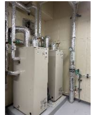
空調設備（床暖房温水巡回ポンプ）
