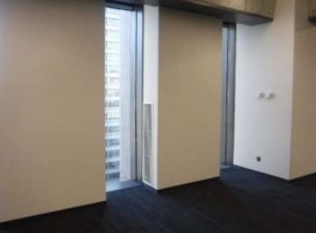
エコマルチウォールによる自然換気
