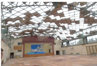
台風で屋根が消失した体育館
