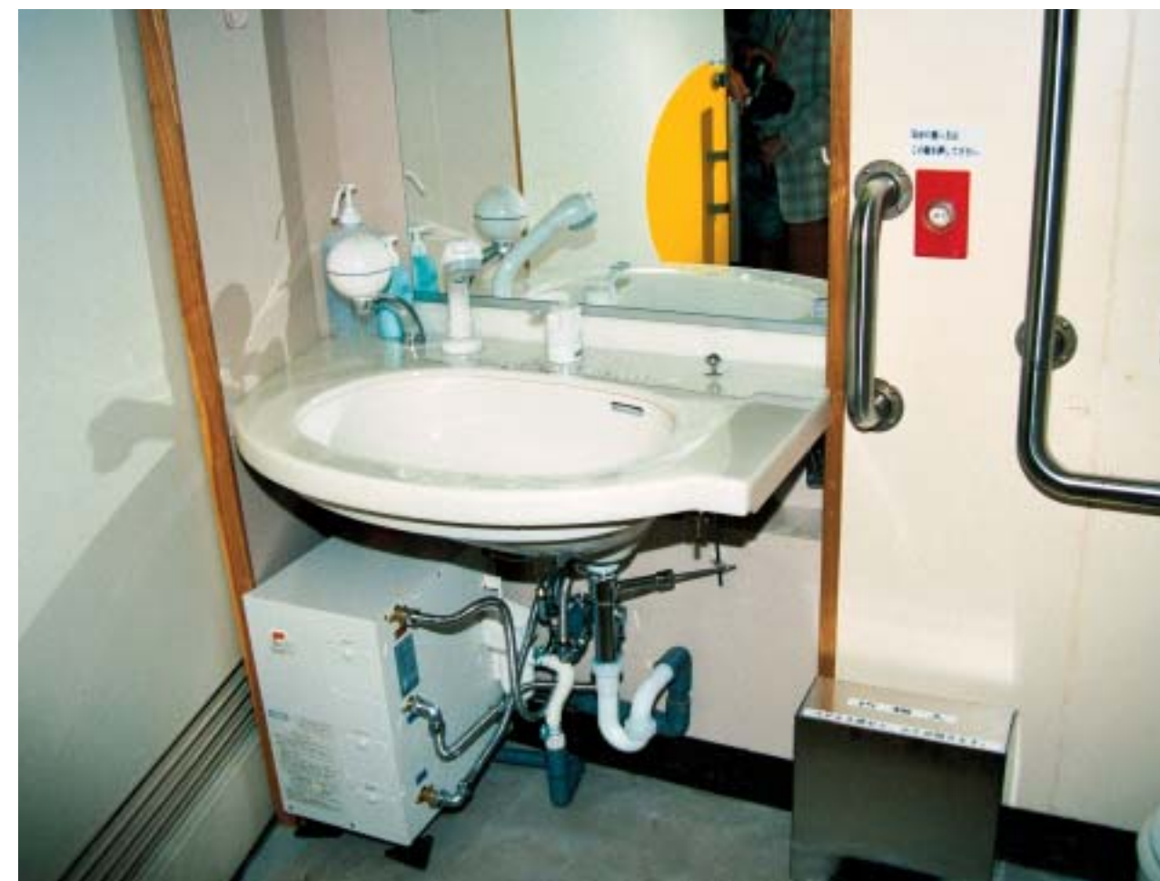
オストメイト対応トイレ（全国公共施設初、習志野市役所）
