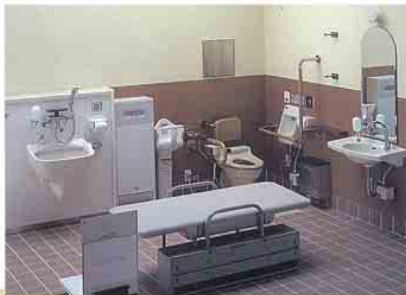
多目的トイレ器具セット空間
