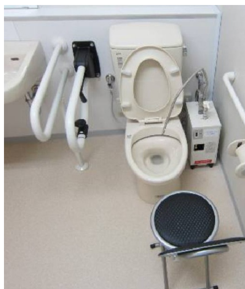
応急仮設住宅集会場への設置例
