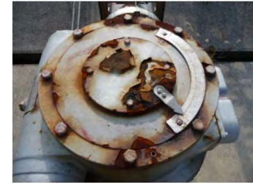
バルブの腐食
