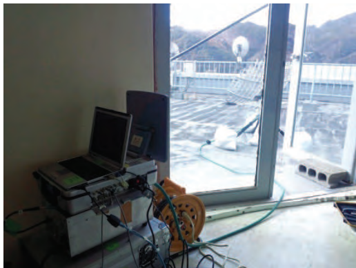
大槌町中央公民館に設置された可搬型通信実験用端末
