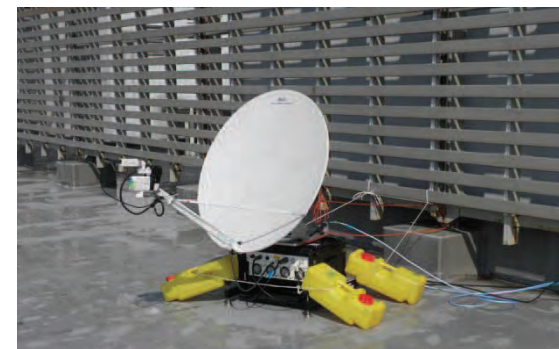
現地対策本部(大船渡)に設置された可搬型VSATの外観写真(アンテナ径1.0m)
