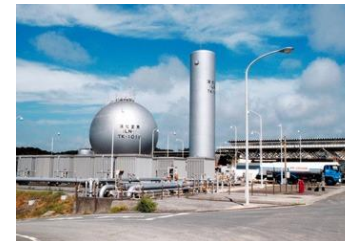
液体貯蔵タンク
