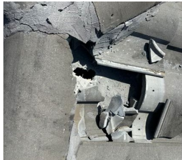
被害家屋の屋根
