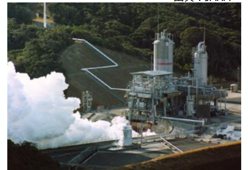
液体ロケットエンジン燃焼試験設備
