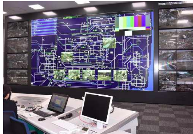
道路交通情報管制センター
